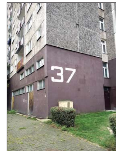
Stan techniczny bloku 37 wskazuje na konieczność pilnej modernizacji
